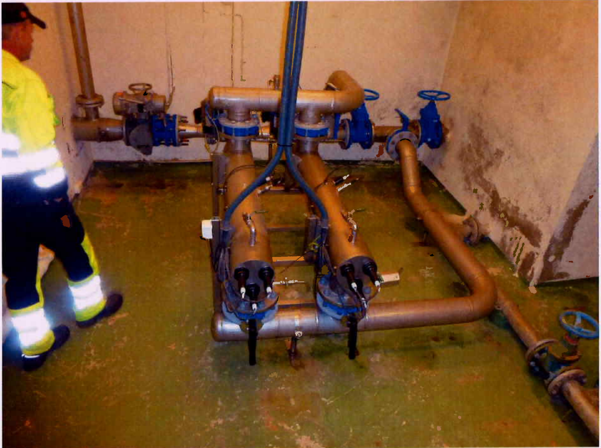
Bilde 4 viser UV-anlegget i vannbehandlingshuset.
