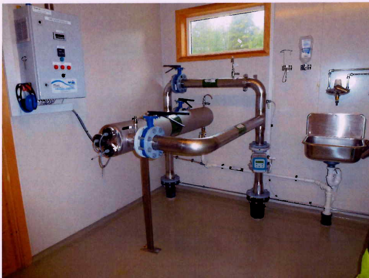
Bilde nr 6, viser UV-anlegget
