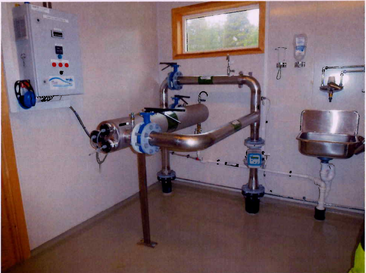
Bilde nr 6, viser UV-anlegget
