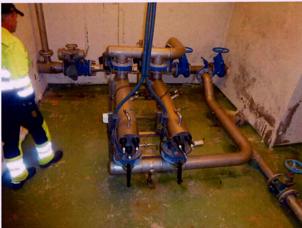
Bilde 4 viser UV-anlegget i vannbehandlingshuset.
