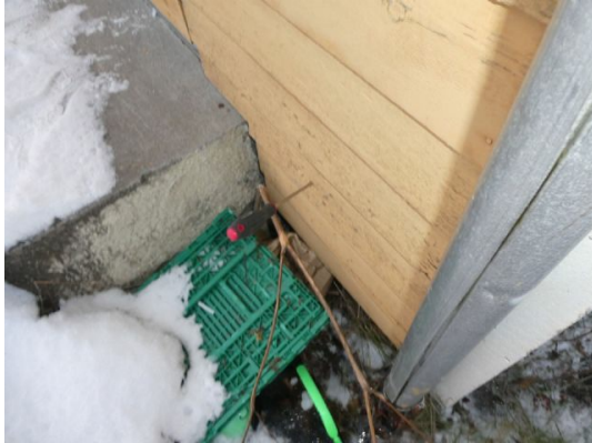
Stedvis meget slitt kledning.
