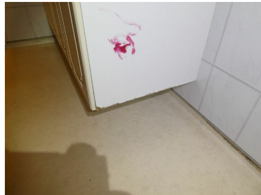
Skade på innredning
