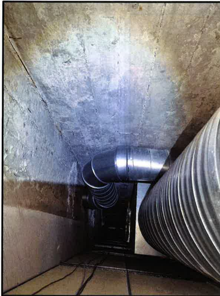
Figur 3.1-7 - Tilstand etasjeskiller over korridor 2. etg.,
