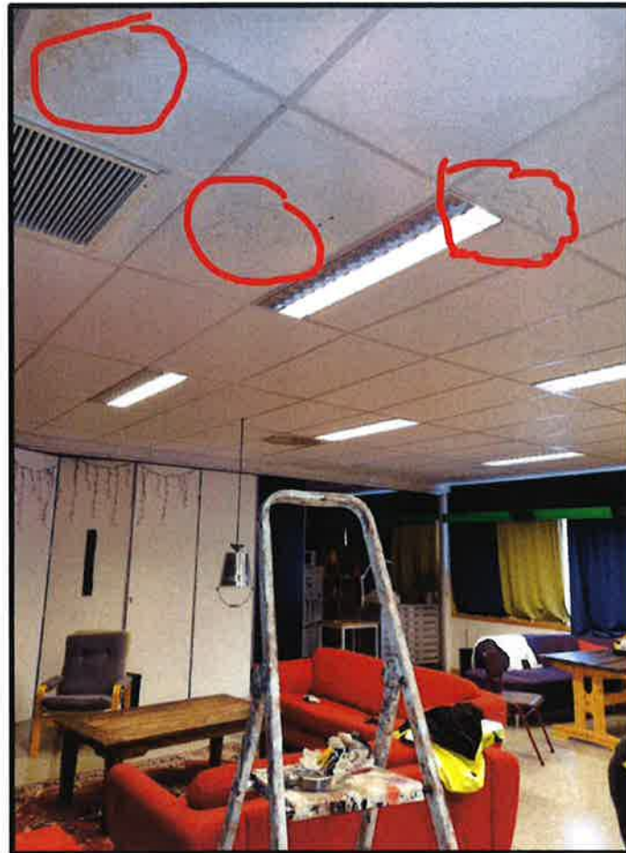
Figur3.1-13 –Fuktskade symptom i himling, utbygd del 2. etg.
