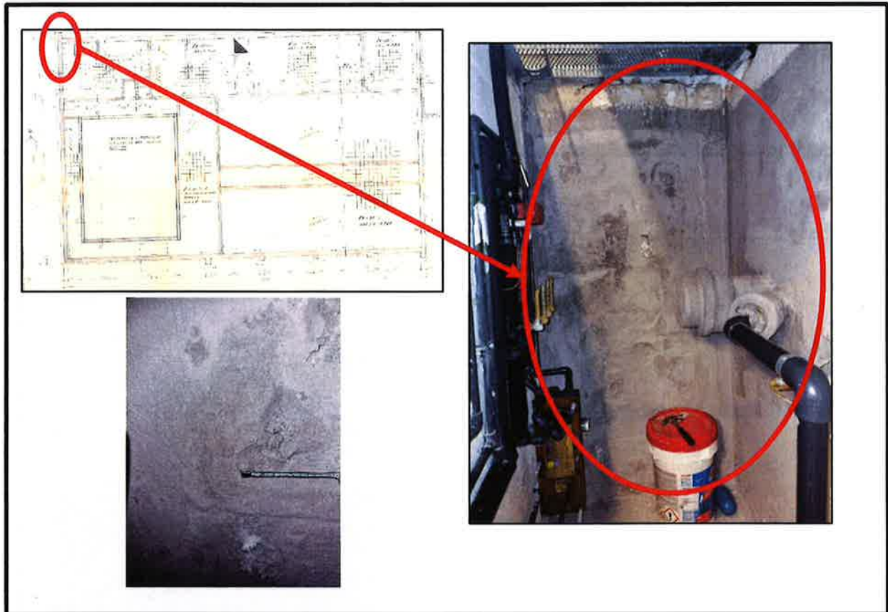
Figur 3.3-2 – Saltutslag og pusskade på grunnmur, sørøstside, renseanleggrom
