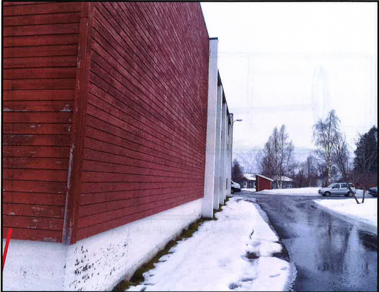
Figur 3.2-5 – Tilstand trekledning yttervegger gymnastikksal, sørøstre del
