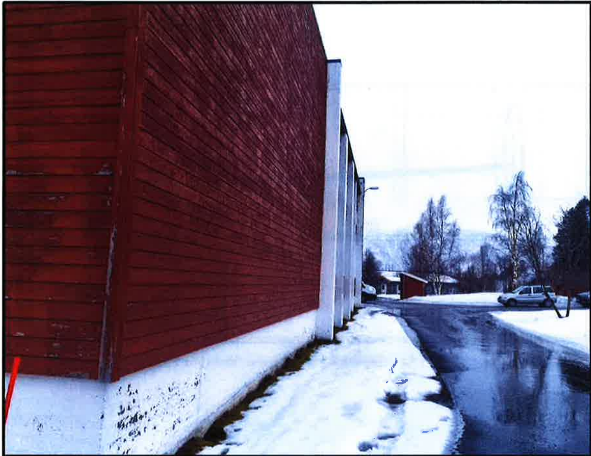
Figur 3.2-5 – Tilstand trekledning yttervegger gymnastikksal, sørøstre del
