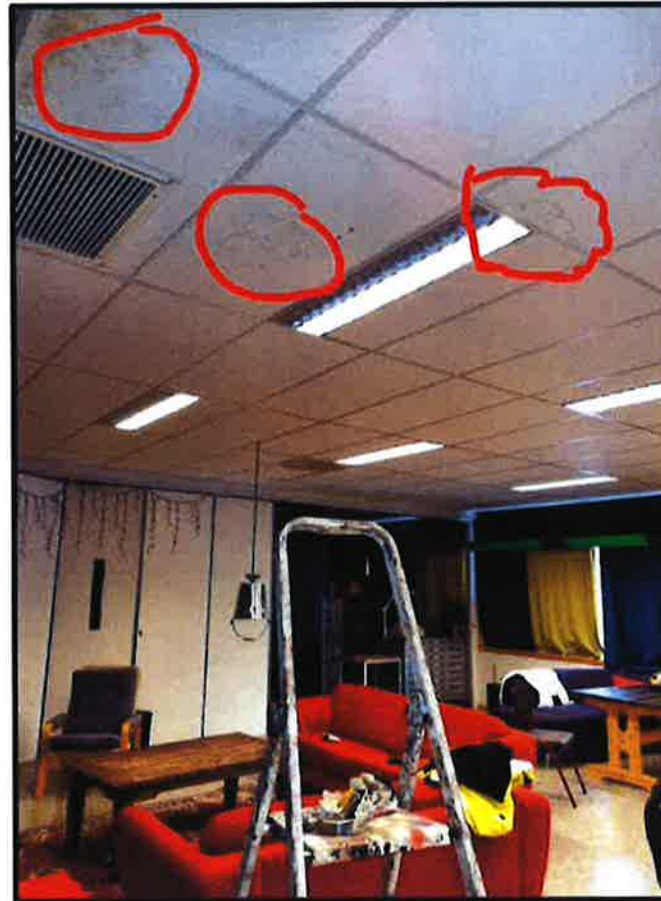
Figur3.1-13 –Fuktskade symptom i himling, utbygd del 2. etg.
