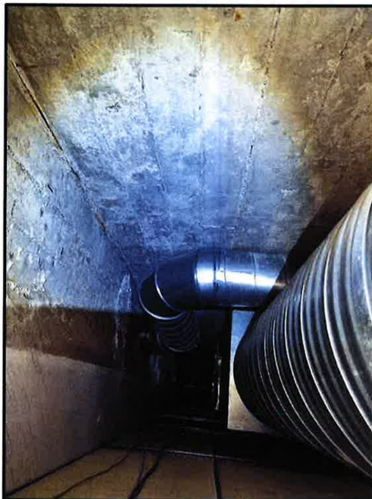
Figur 3.1-7 - Tilstand etasjeskiller over korridor 2. etg.,
