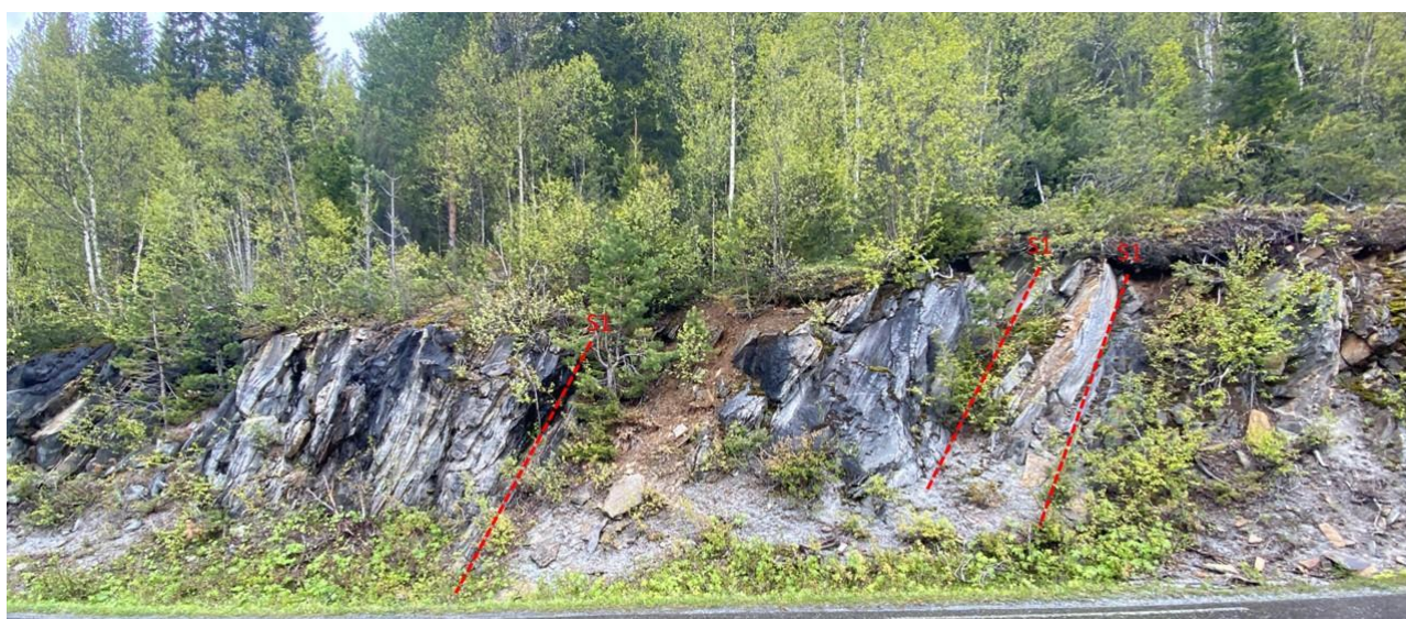
Figur 12: Bergskjæring langs eksisterende veg med inntegnet oppsprekking.
