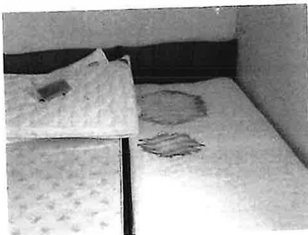
Fukt i madrass hvor seng er like under himlingsplate hvor det er gjennomslag
