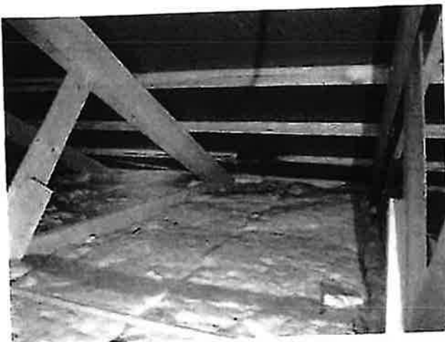
Bilde tatt mot ene punkt/lekter hvor det er fukt i lekter, det er flere steder hvor det er fukt/gjennomslag.
