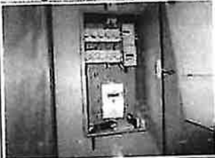
Bilde tatt mot sikringskap
