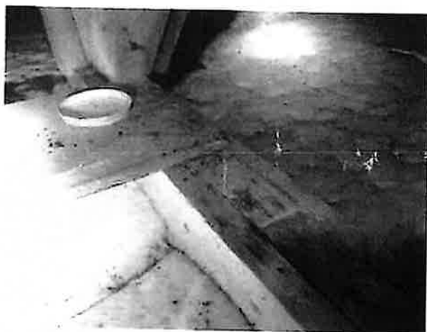
Bilde tatt fra åpning til kaldloft hvor det mye muselort/avføring i område og til kaldloft. Det er satt ut skåler flere steder, sannsynlig kjent for eier/ tidligere eier.
