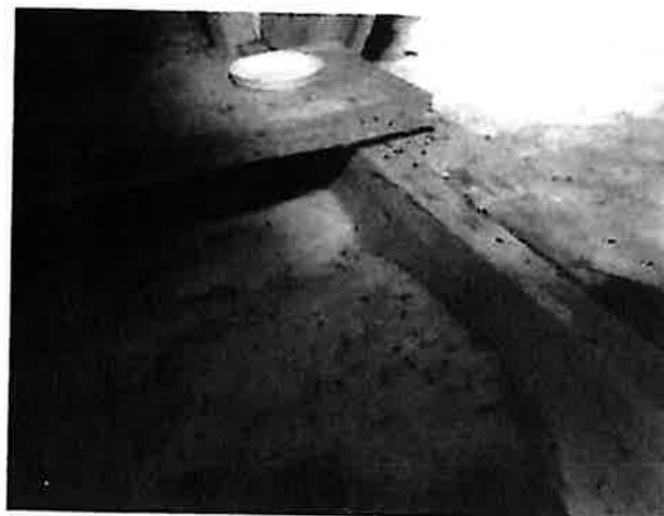
Bilde tatt fra åpning til kaldloftet, åpning hvor det er muselort/avføring, sannsynlig mye urin i isolasjonen også.
