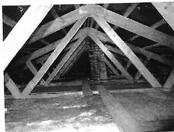
Pipe er skjev fra kaldloft og over tak, har sot som har rent ned langs pipen
